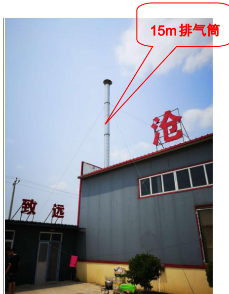
图 3-2 混凝土搅拌排气筒
