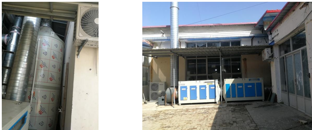
图 4.1-1 喷淋塔、UV 光氧催化+活性炭照片
