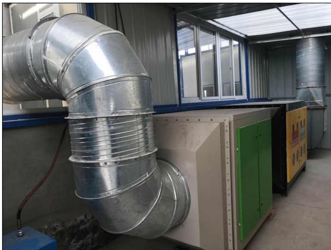
多元复合光氧、等离子废气处理设备+活性炭吸附装置
