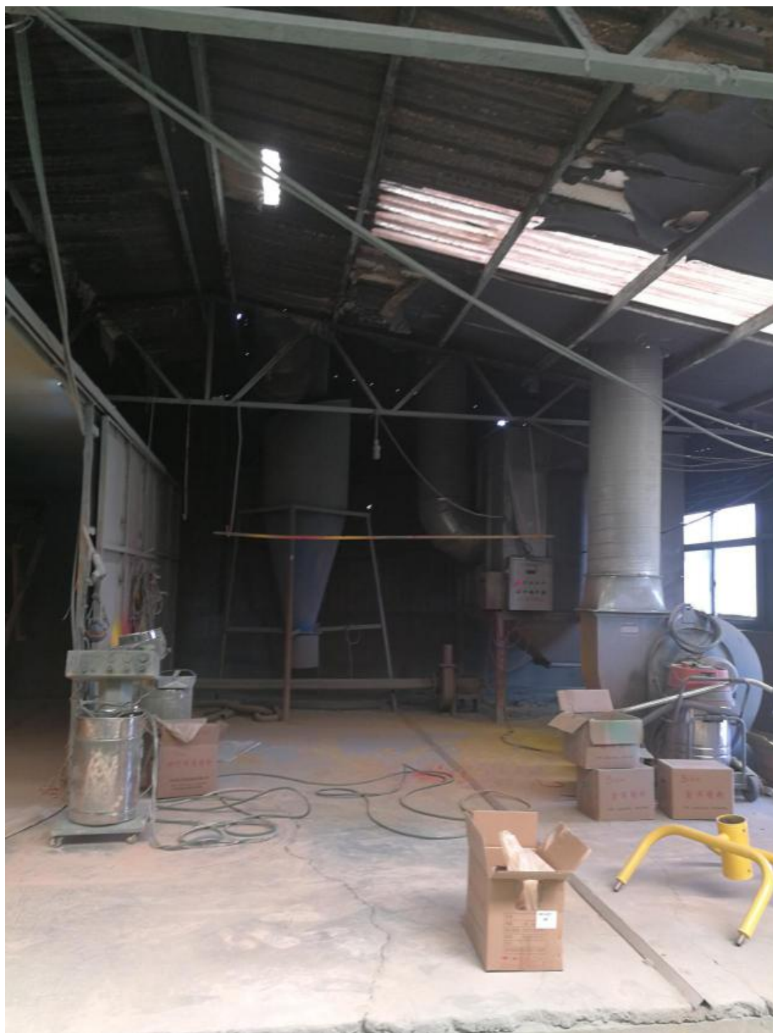
旋风除尘器+布袋除尘器
