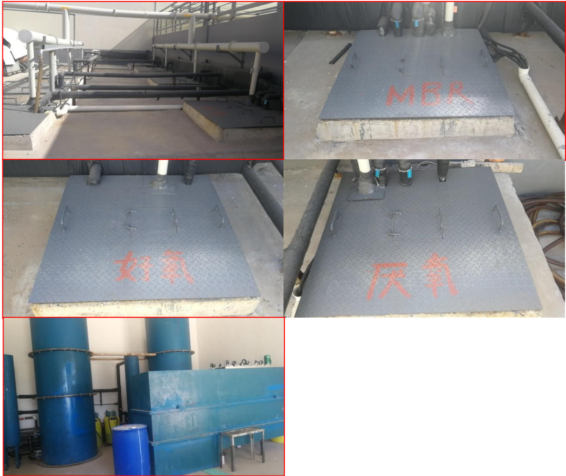
图 4.1-2 污水处理设施照片
