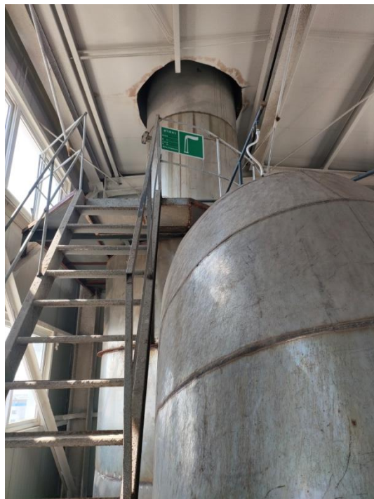
水吸收装置及采样平台
