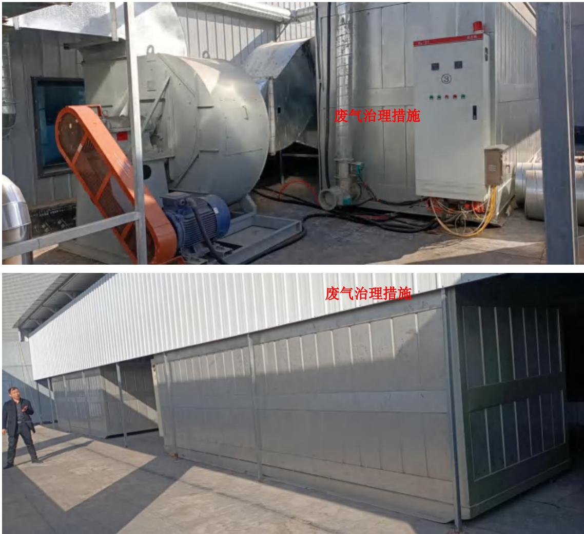
图 4.2-1 废气处理措施建设情况
