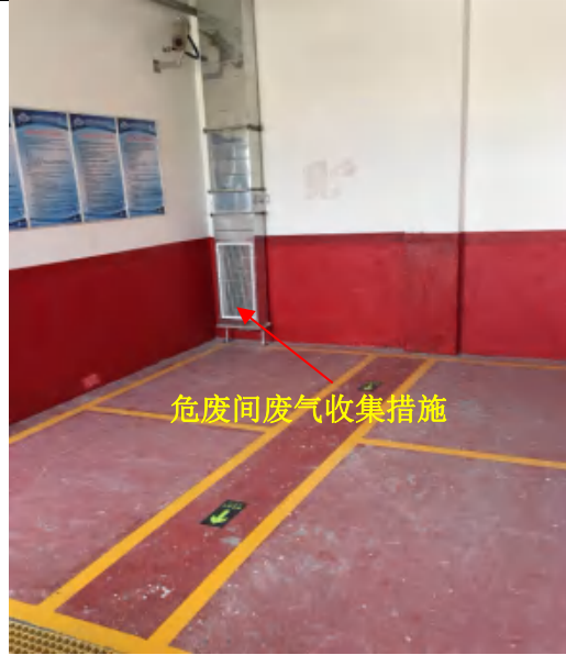
危废间废气收集措施
