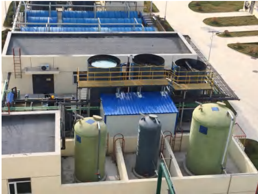
污水处理站池体加盖密闭收集
