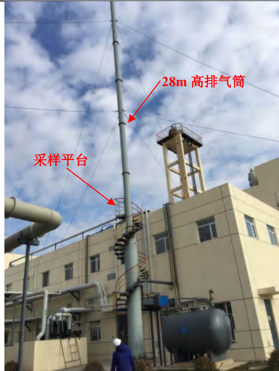
图 4.2-3 导热油炉废气处理措施建设情况
