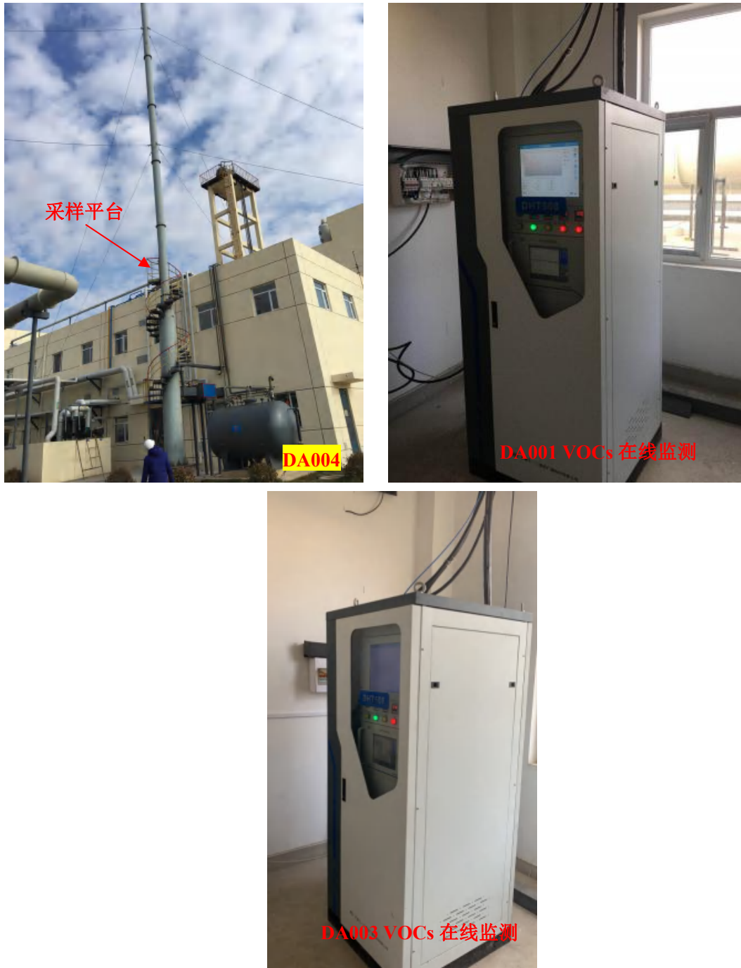
图 4.3-1 废气措施采样平台、排气筒、在线监测
