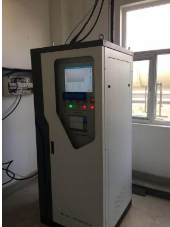
废气在线监测系统
