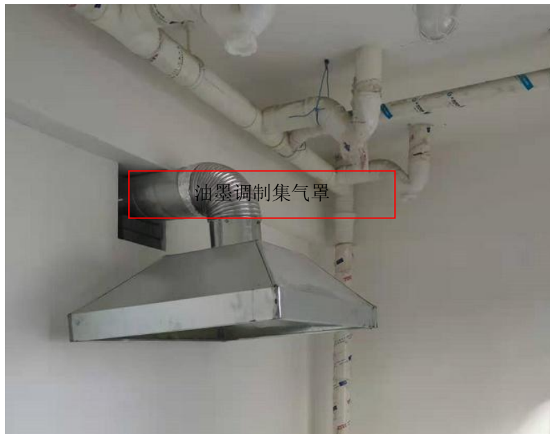
图4.1-4 油墨调制工序集气罩实际建设情况
