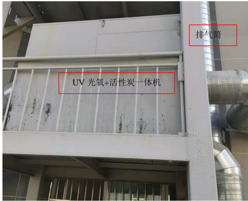
图4.1-5 废气处理措施实际建设情况
