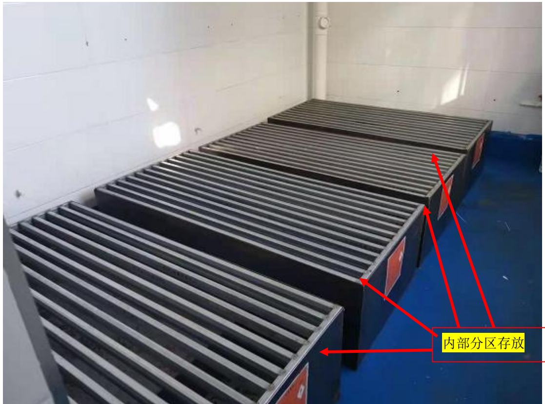
图4.1-6 危废间内部危废分区存放情况（带格栅的防漏槽）
