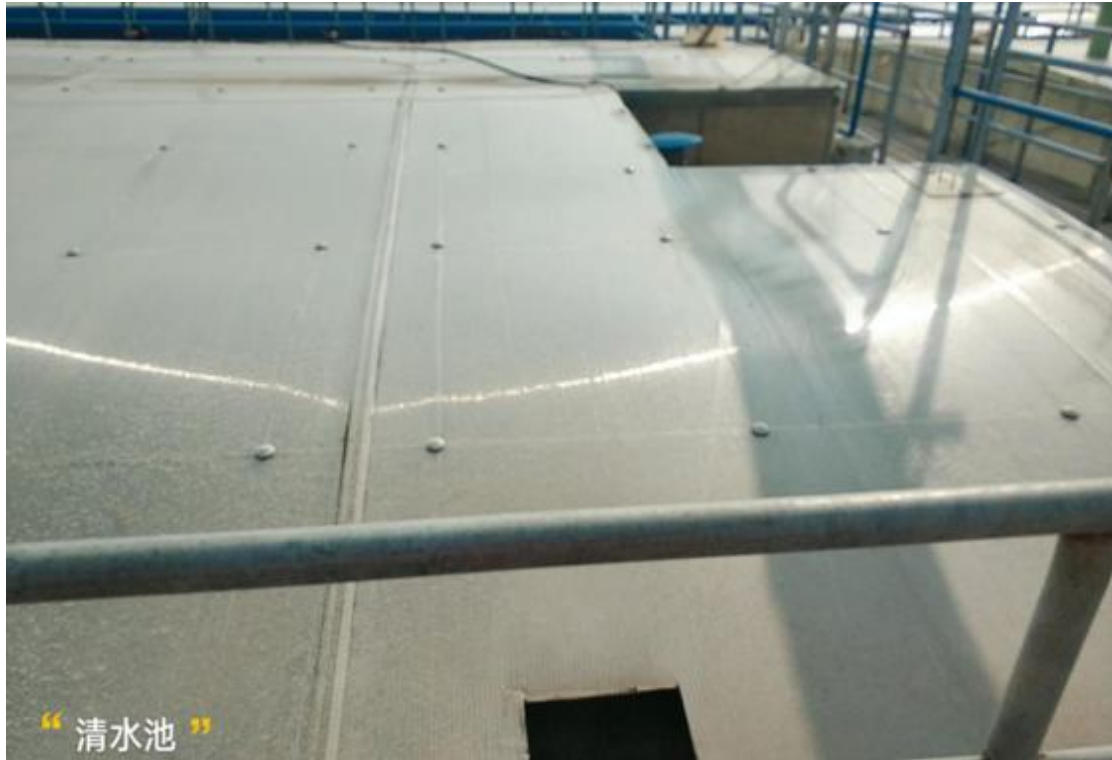
图5.2-1 本项目废水治理设施
