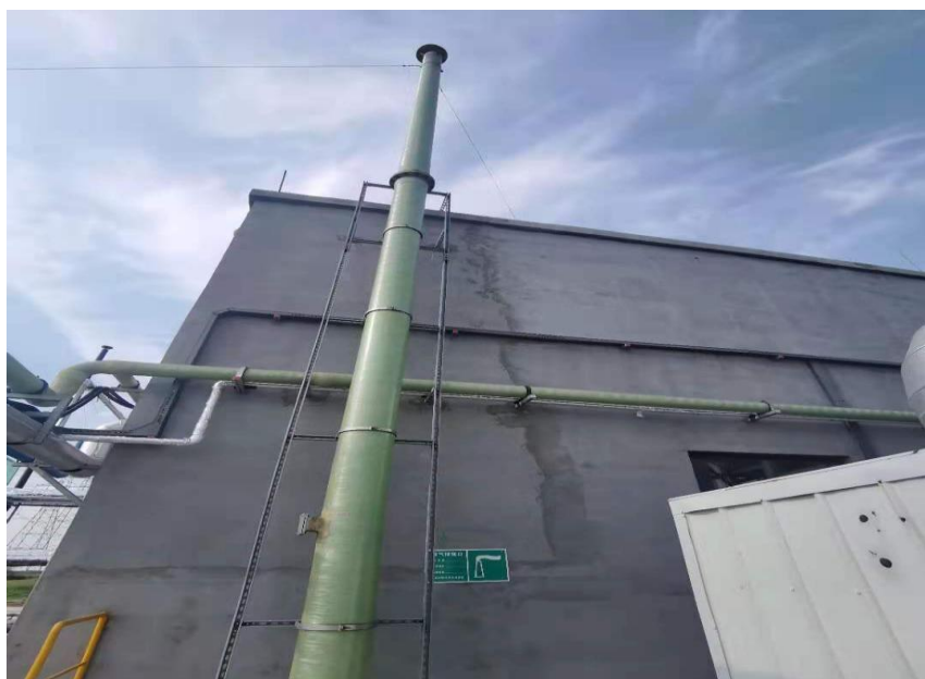
污水处理废气排气筒
