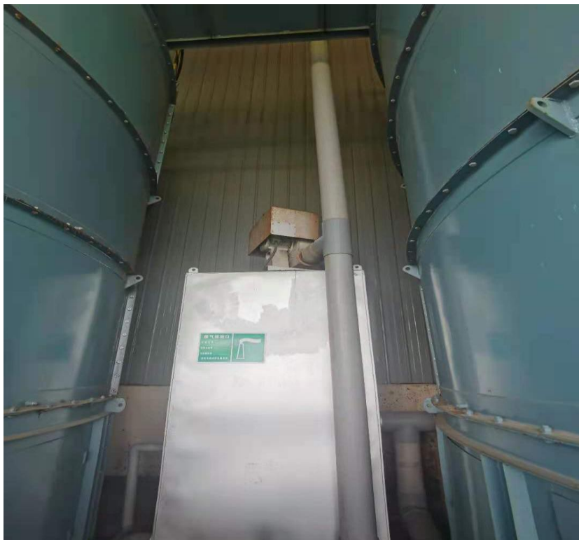
发酵罐 3#排气筒
