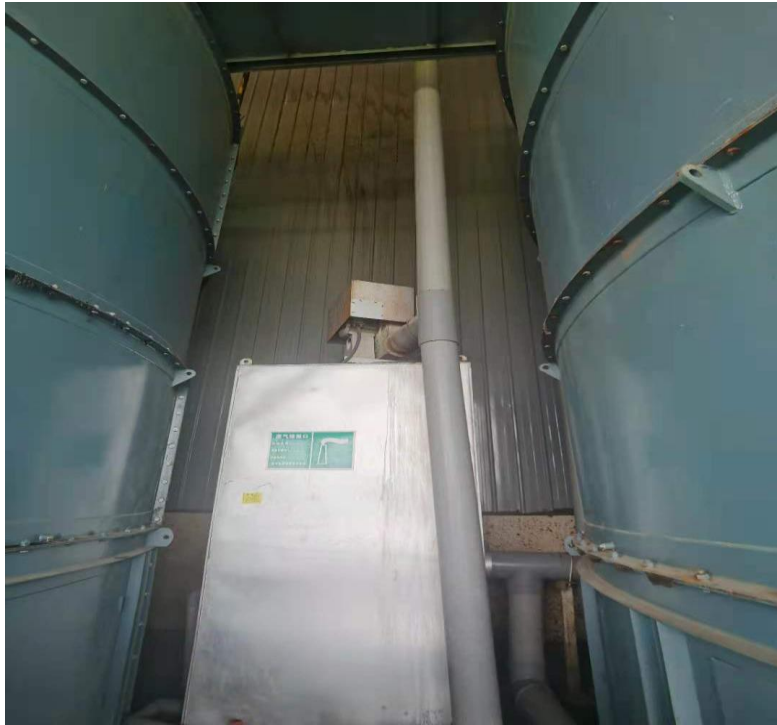
发酵罐 2#排气筒
