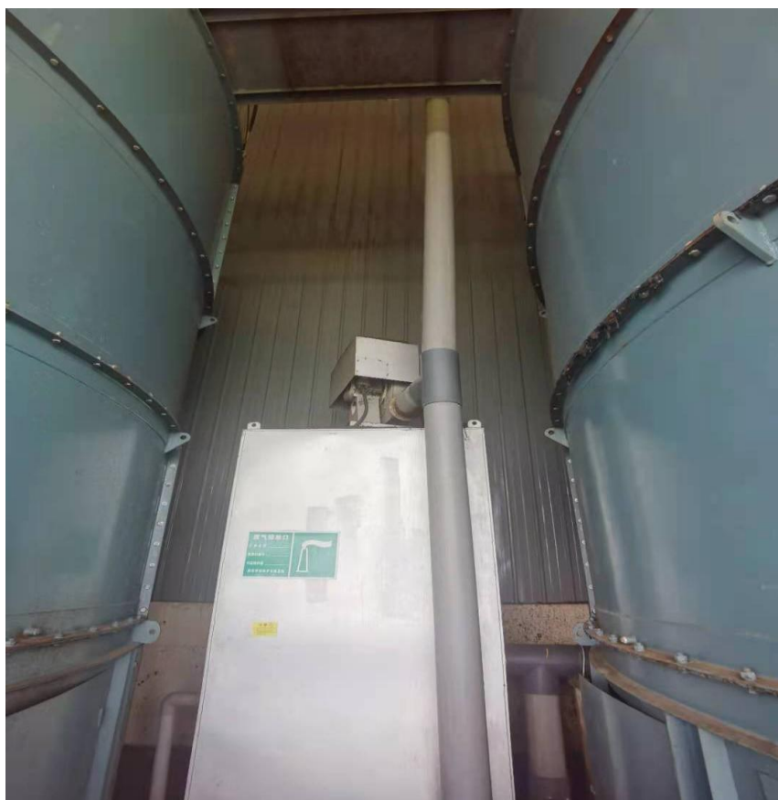
发酵罐 4#排气筒
