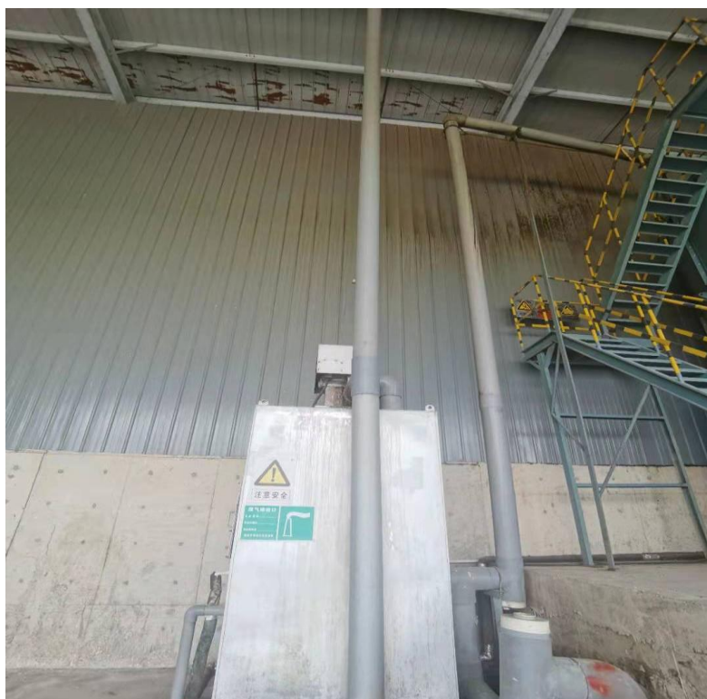
发酵罐 1#排气筒
