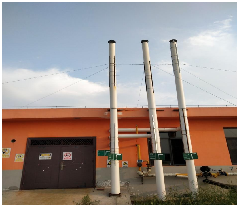
生活区 3 根锅炉排气筒
