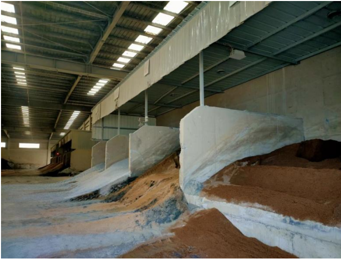
料仓内配料坑半封闭空间及集气管道
