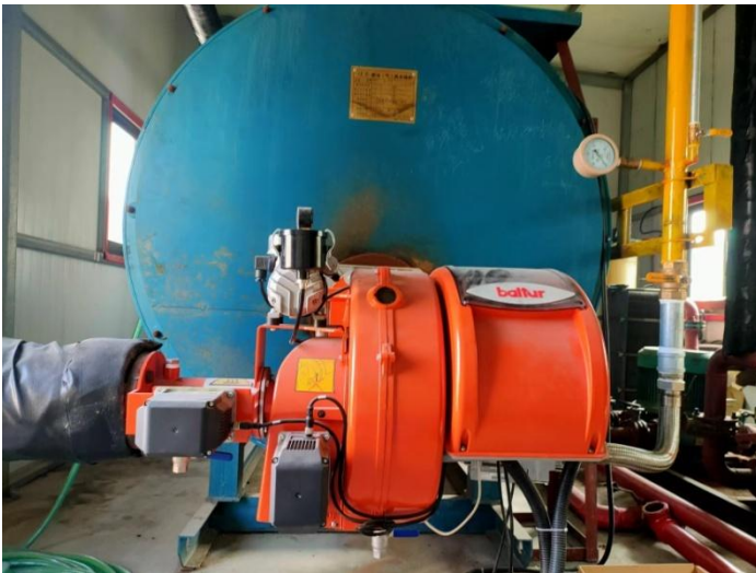
锅炉低氮燃烧器
