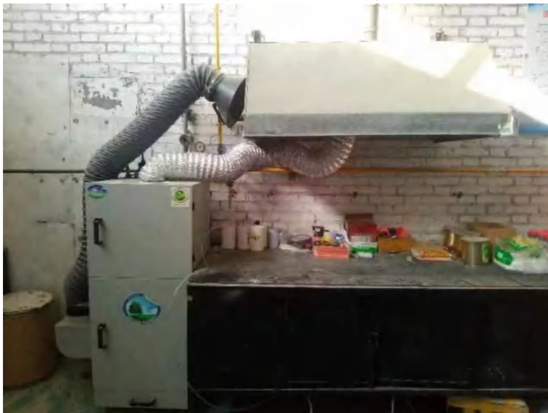
图 4.2-3 集气罩收集+布袋除尘器
