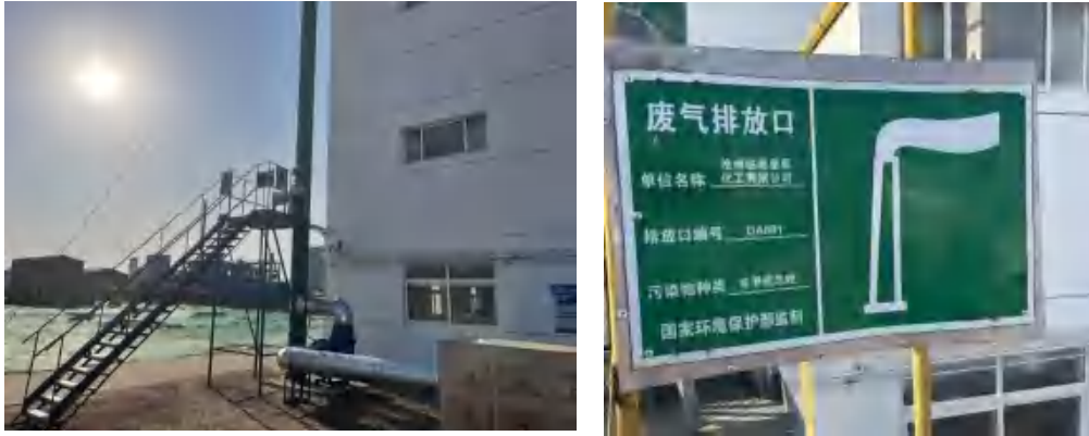
图 4.2.-15 废气排放口标志牌、取样平台图
