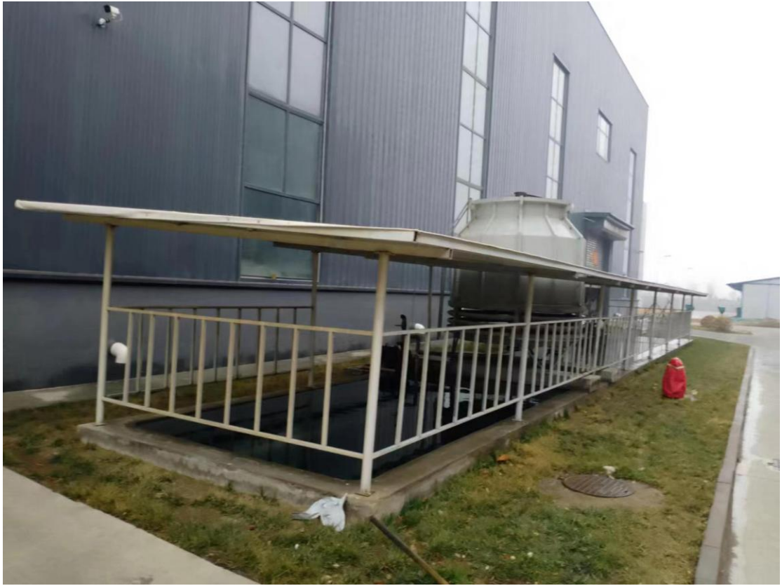
图 4.2-6 地下冷却水池
