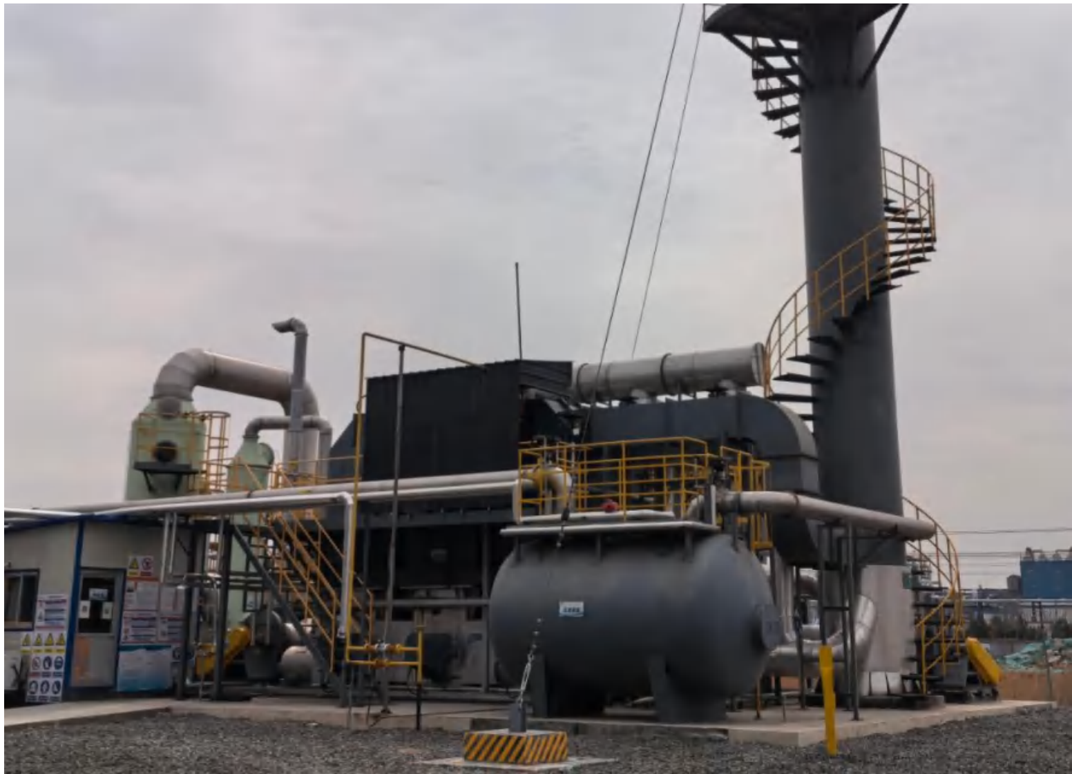
DA001 排气筒及废气处理设施
