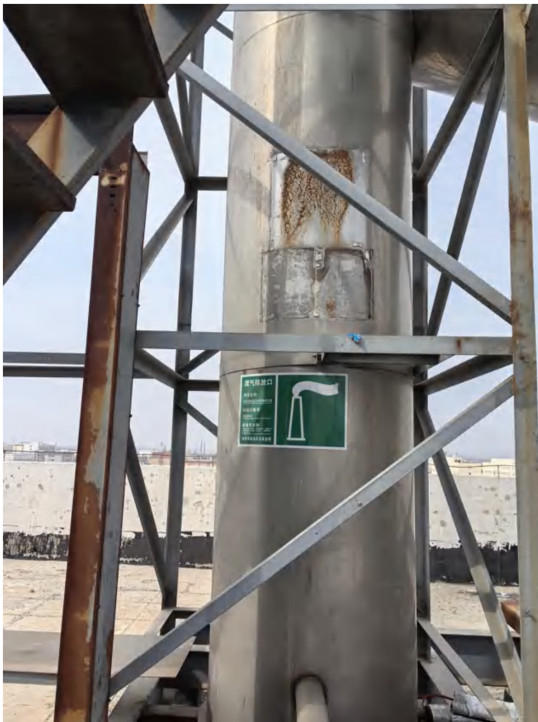
图 4.2.5-4 废气 DA004 排放口标识牌
