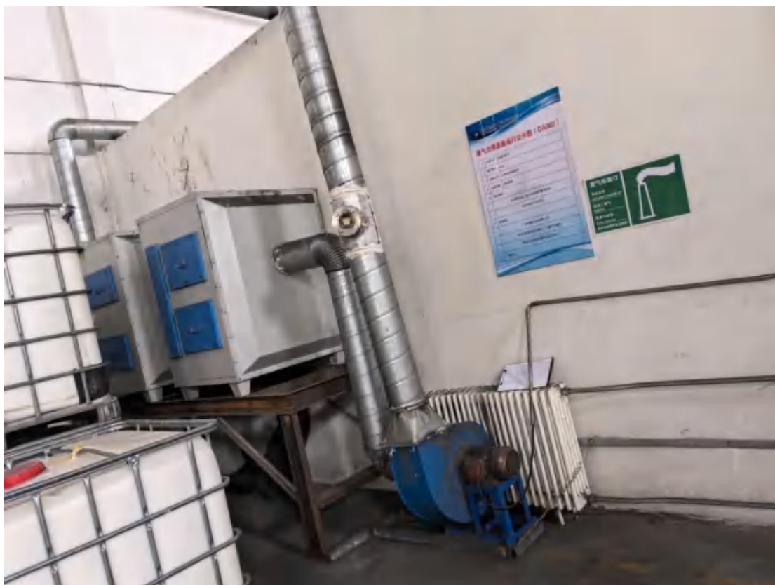
DA002 排气筒及废气处理措施
