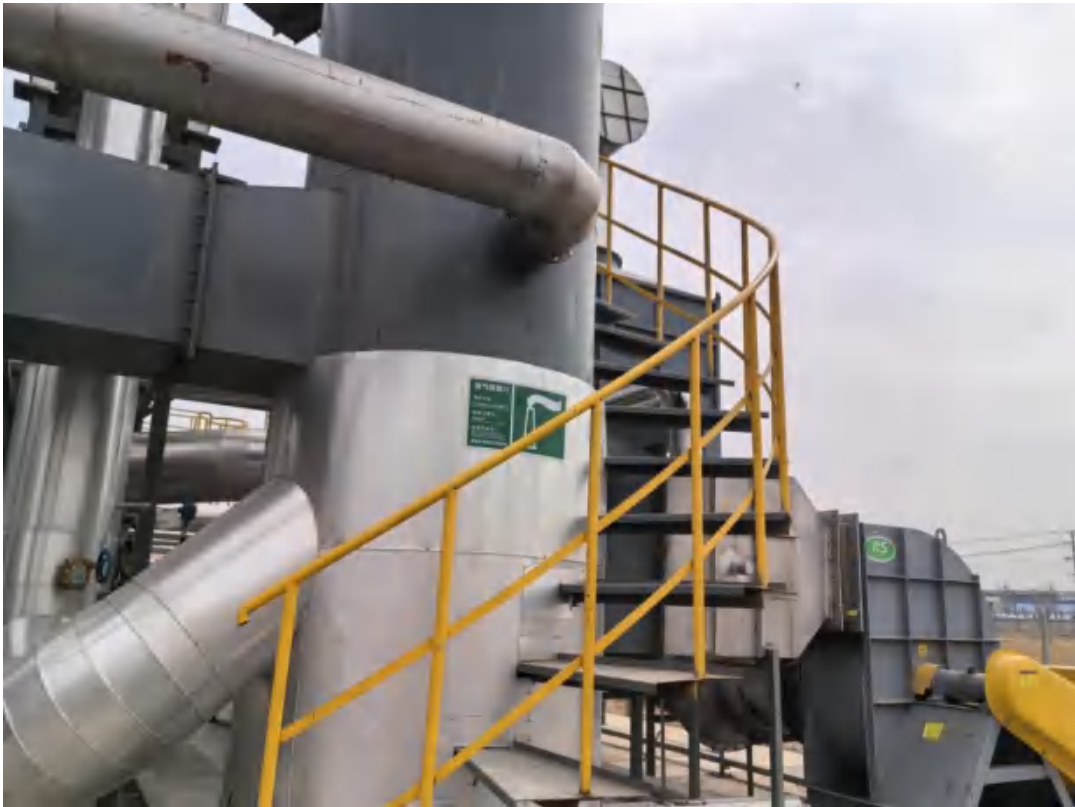
图 4.2.5-1 废气 DA001 排放口标识牌
