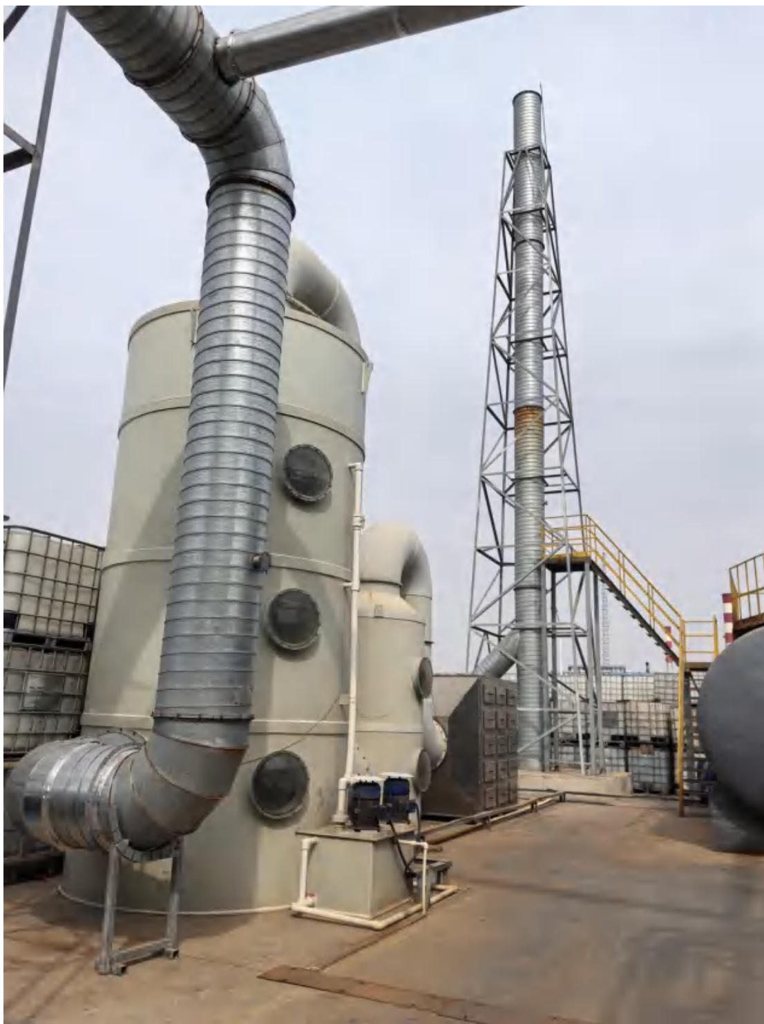
DA003 排气筒及废气处理措施
