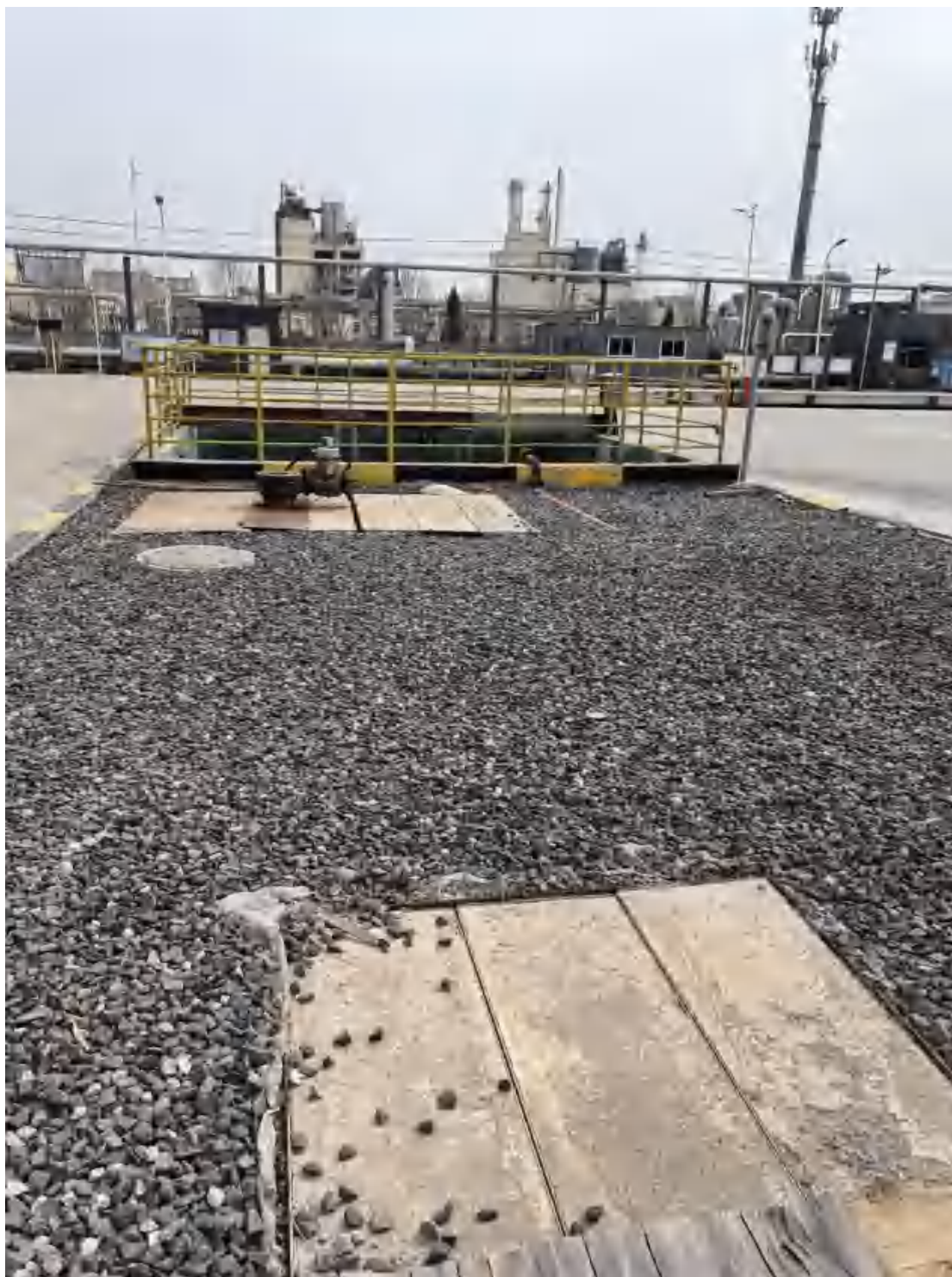
图 4.2.5-10 雨水提升池标识牌
