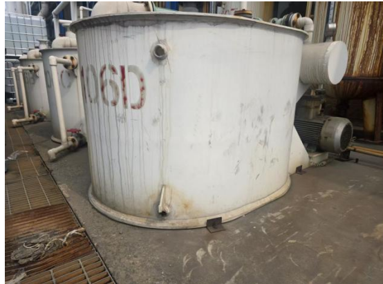
车间处理设施
