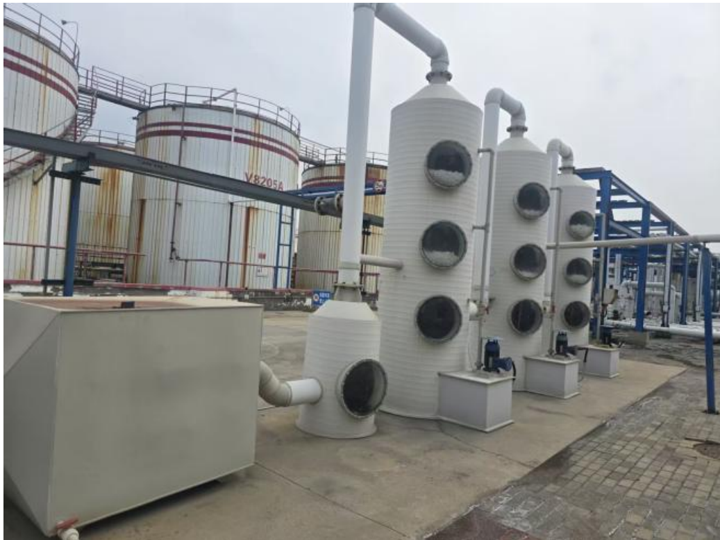
罐区废气治理设施
