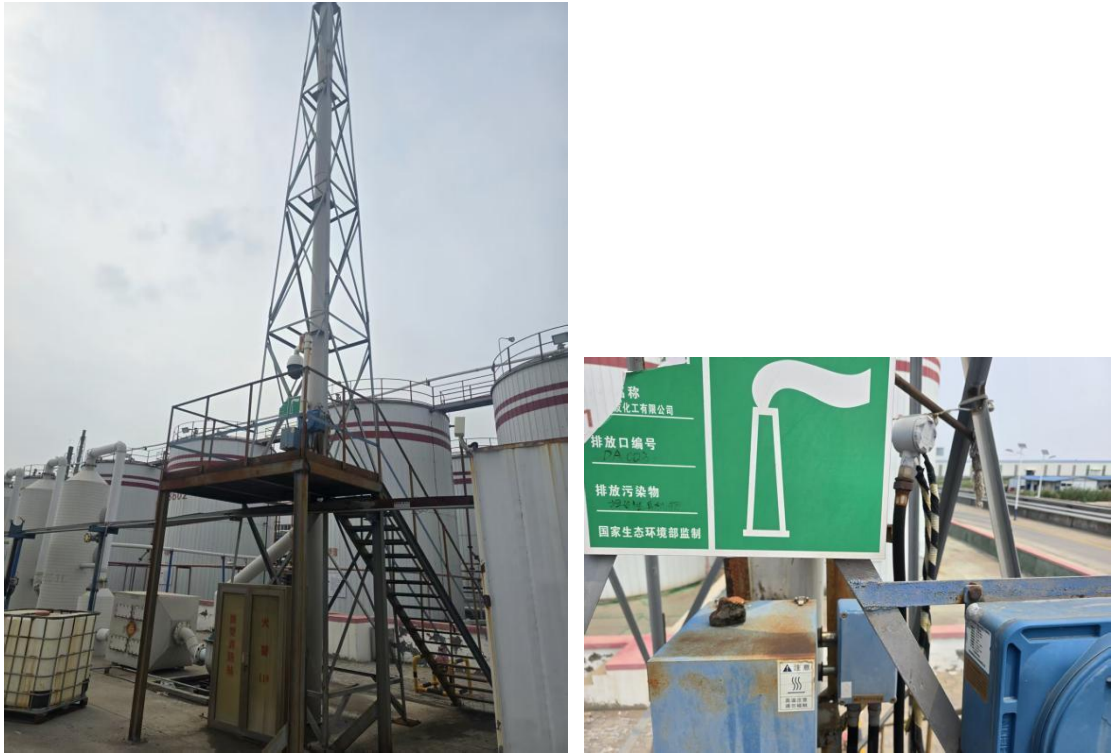
DA003 排气管道
